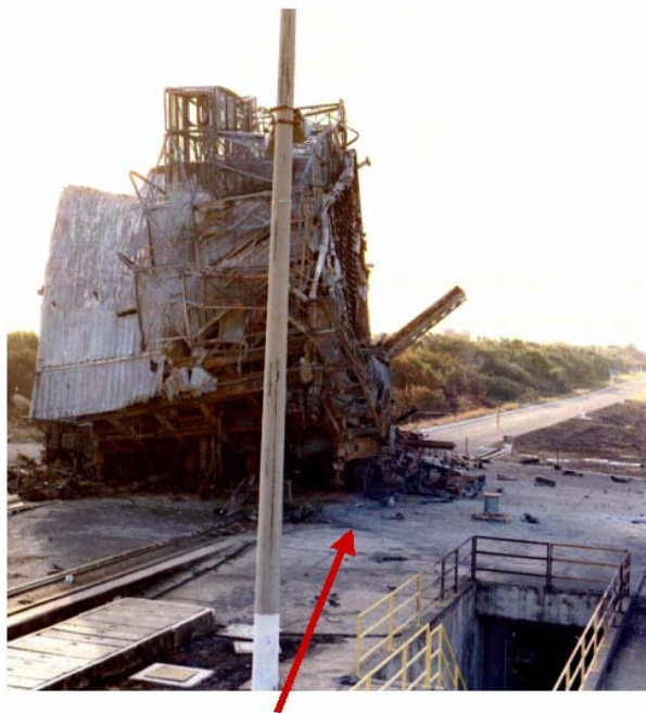
Figura 62 - Detalhe do piso de concreto, na lateral direita da torre móvel de integração, podendo-se perceber, com clareza, a deposição de resíduos de alumínio em forma de cone, projetando-se, inclusive, sobre o guarda-corpo que protege a entrada da sala de interface.
