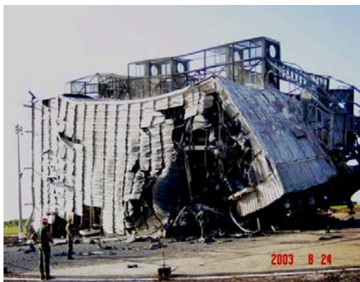
Figura 59 - Vista lateral da torre móvel de integração, lado dos propulsores C e D.
