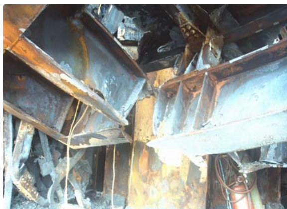
Figura 57 - Imagem das vigas que tiveram material removido por ação do jato de gás quente do propulsor A (ação de maçarico).
